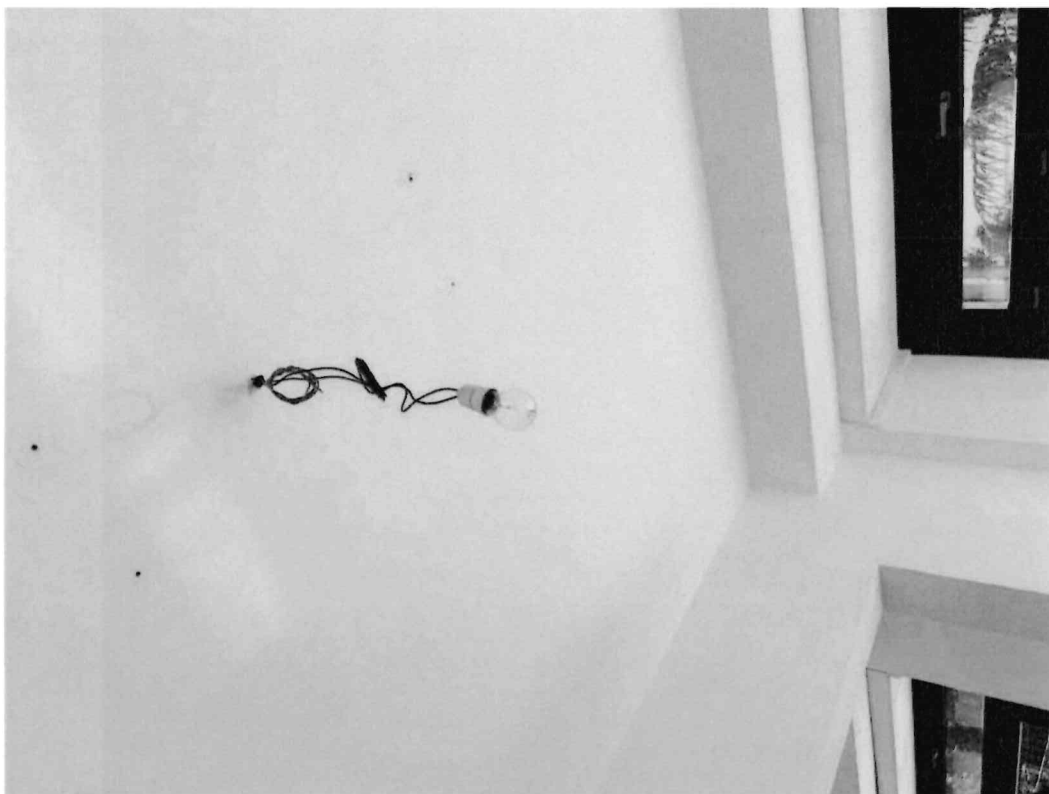
Foto nr. 9 – Particolare punto luce - da sistemare.
