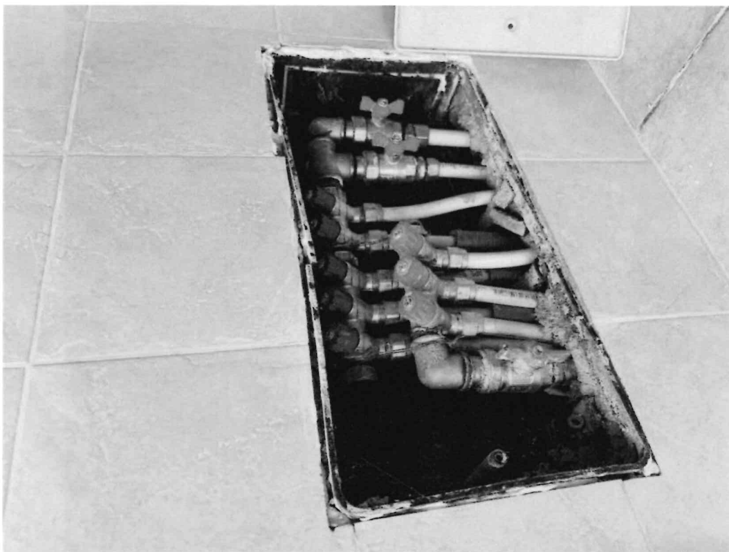
Foto nr. 3 – Collettori complanari C/F – servizio igienico – con tubazioni in multistrato
