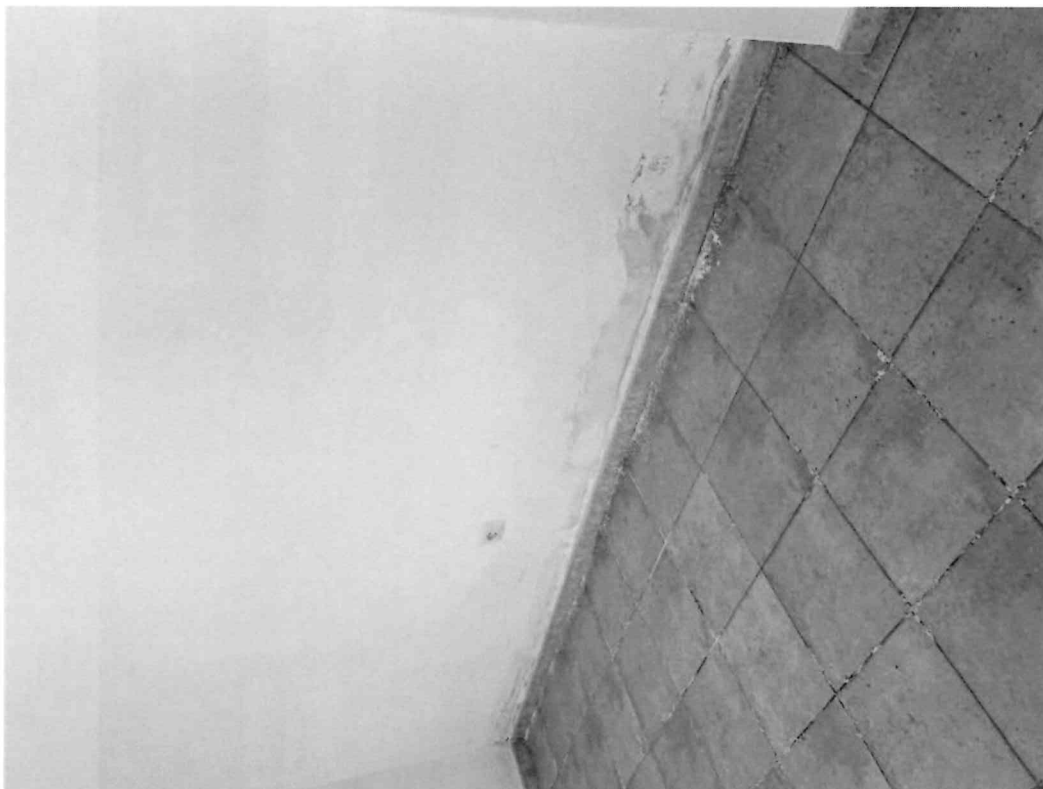
Foto nr. 7 – Parete posteriore con problematiche di infiltrazione.
