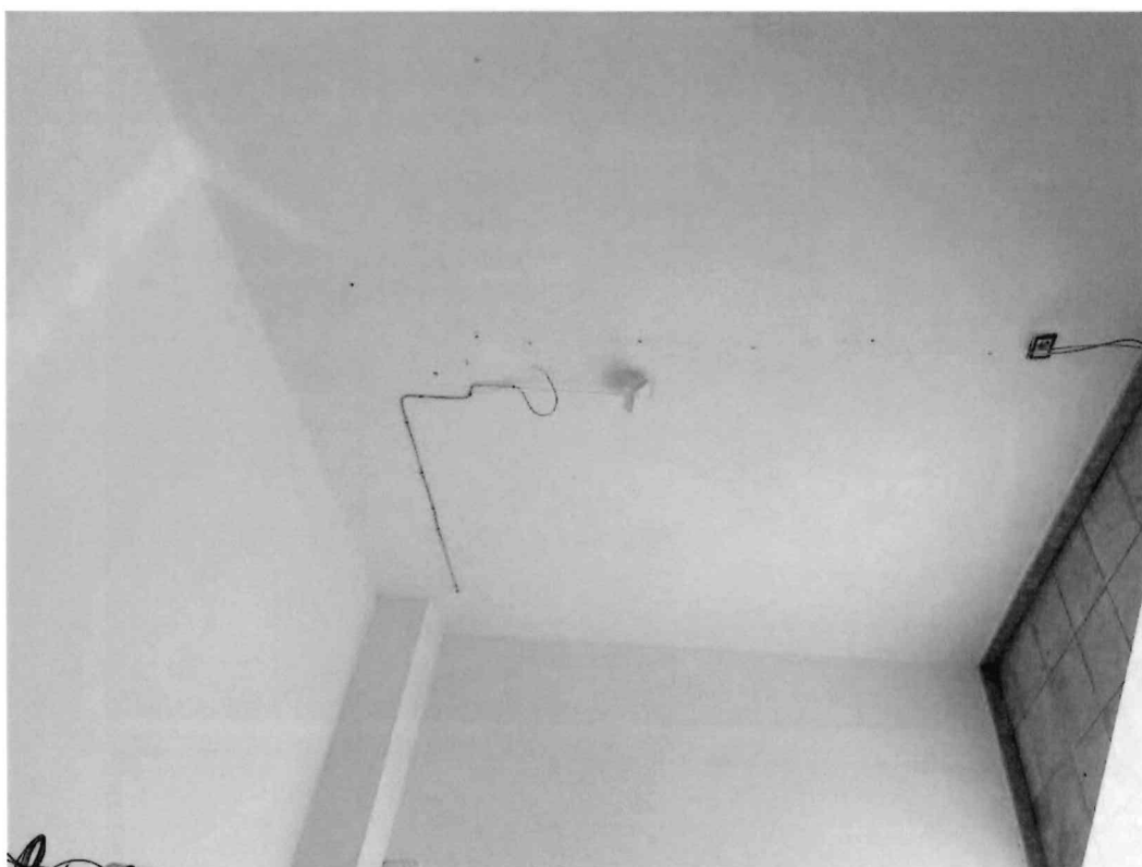
Foto nr. 10 – Particolare prese - da sistemare.
