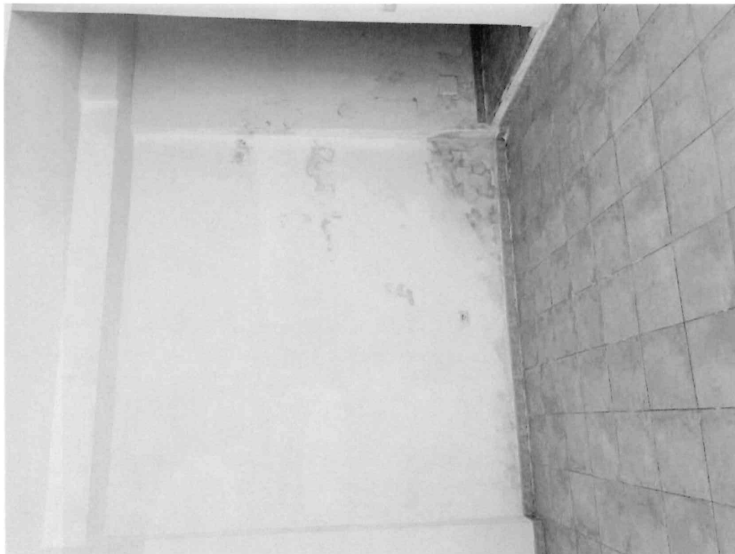
Foto nr. 6 – Parete posteriore con problematiche di infiltrazione.
